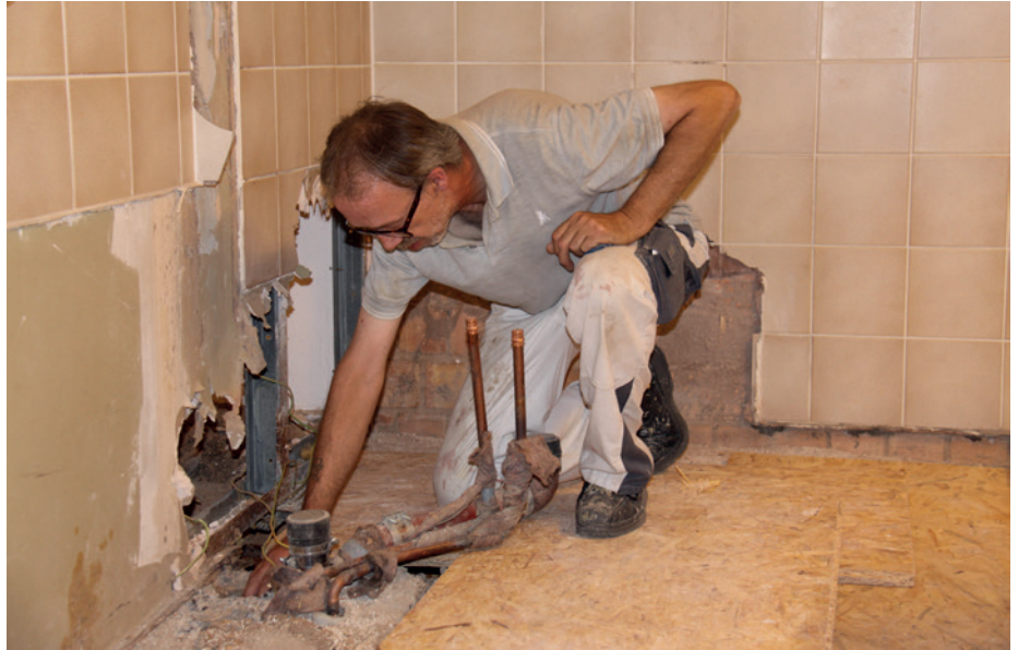
Wasserschaden – eine individuelle Lösung wird verlangt.
